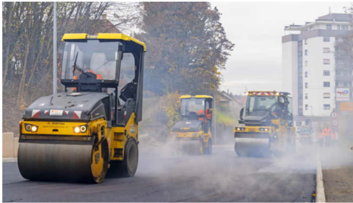
Eine so große Maßnahme wie die Sanierung der Saarbrückener Straße im vergangenen Jahr steht dieses Jahr nicht an. Dennoch hat sich die Stadt wieder viel vorgenommen. Foto: Archiv/Häffner
