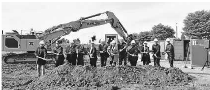
Spatenstich für das Baufeld K im Neckarbogen mit Oberbürgermeister Harry Mergel (5. v. r.), Reiner Nagel, Vorsitzender der Baukommission (6. v. l.), Bürgermeister Andreas Ringle (2. v. l.), Bürgermeister a.D., Wilfried Hajek (3. v. l.) und den Bauherren und Bauherinnen
